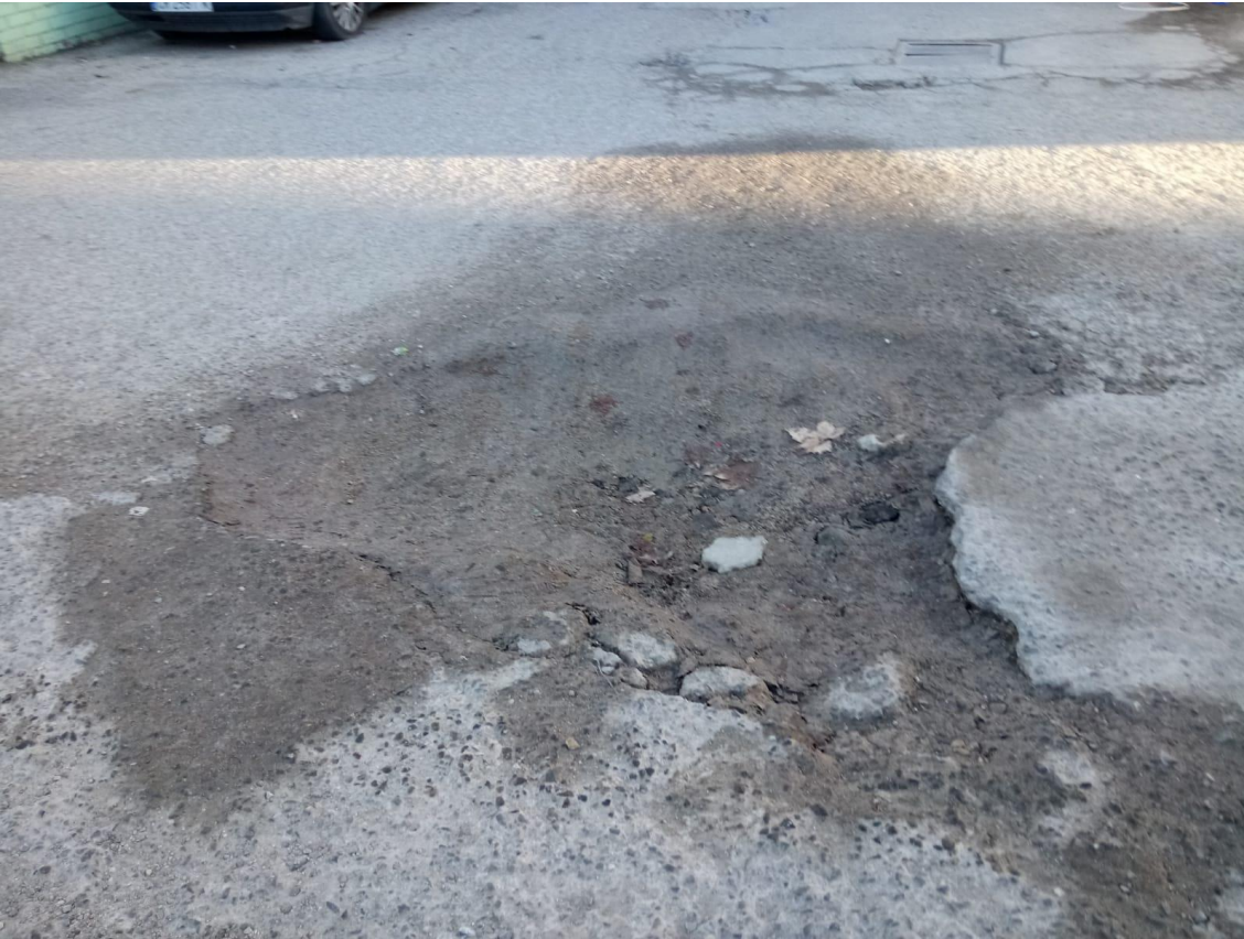
Numerosos desperfectos y socavones en calle Plomo y otras (a modo de ejemplos)
